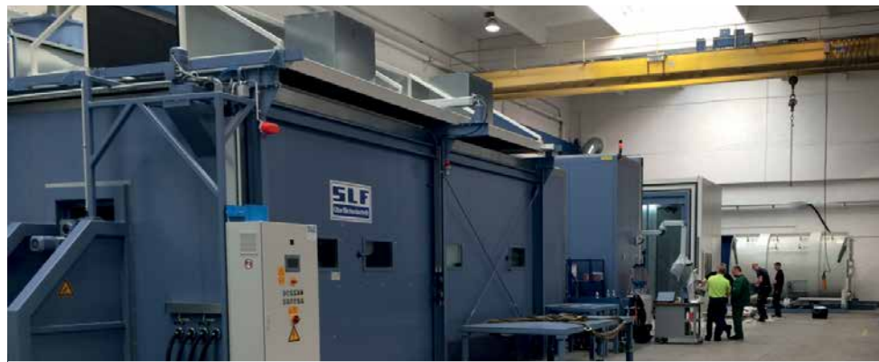
Instalación de granallado para el tratamiento de rodillos en la planta en Mönchengladbach, Alemania
