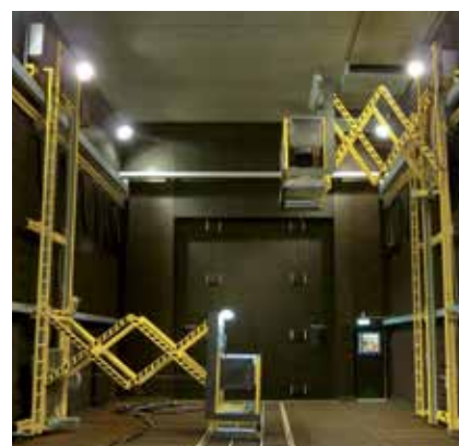
Телескопическая подъёмная рабочая площадка в дробеструйной камере
