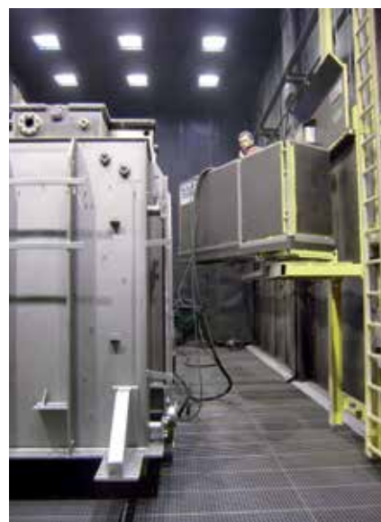
Поворотная подъёмная рабочая площадка в дробеструйной камере
