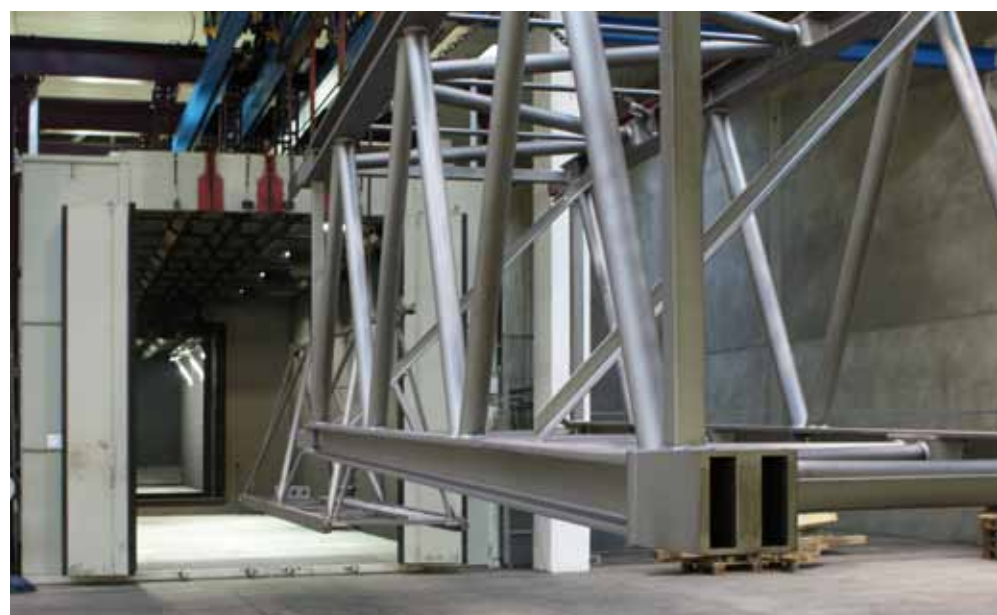
AGTOS-Durchlauf-Hängebahnstrahlanlage (3,5 x 2,5 x 32 m)
