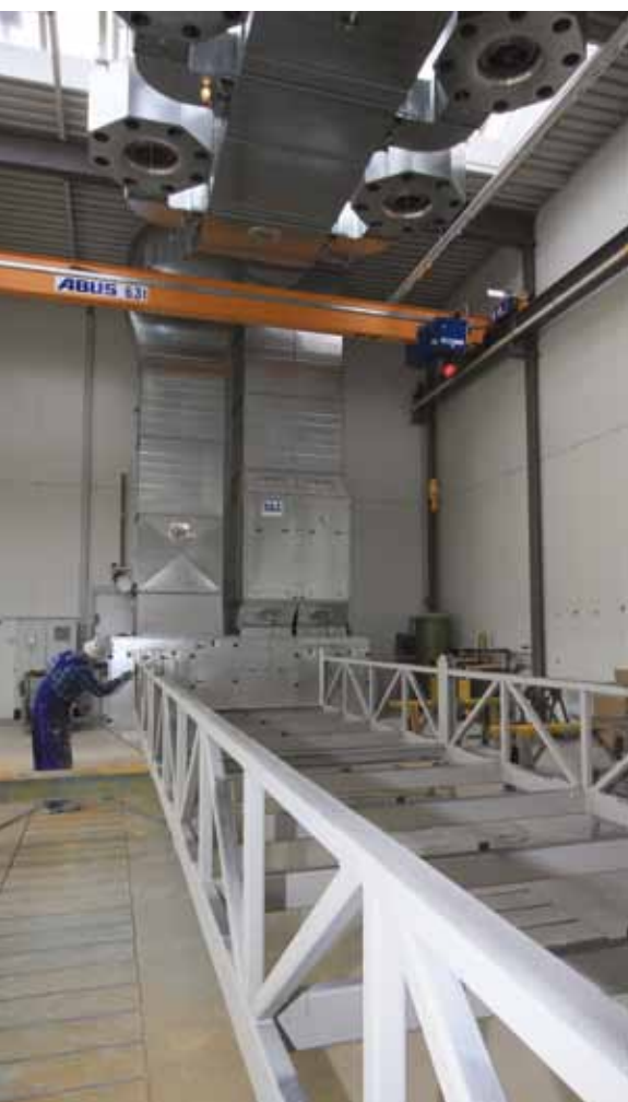
Freiflächenlackieranlage für großen Stahlbau
