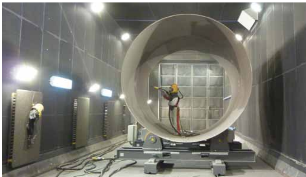
Дробеструйное помещение открытого типа для башен ветровых установок
