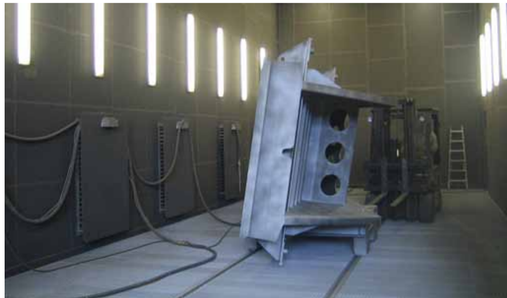
Freistrahlraum mit vollflächiger Strahlmittelrückförderung.
