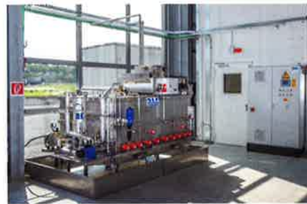
Prozesswasseraufbereitungsanlage und Schaltschrank © SLF Oberflächentechnik GmbH
