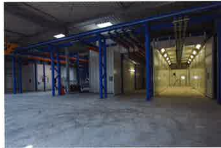
Gesamtanlage aus Freistrahraum, Spritz- und Trockenkabine, Lacktrockner und Hochdruckreinigungskabine © SLF Oberflächentechnik GmbH
