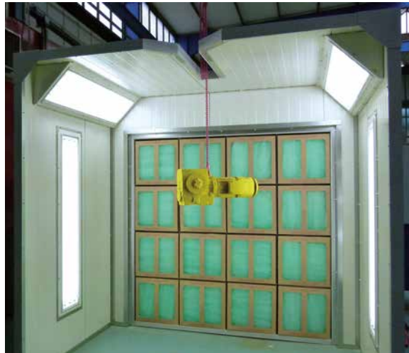
Spritzstand mit Kartonfiltern und Kranschlitz für Beladung mittels Hallenkran
