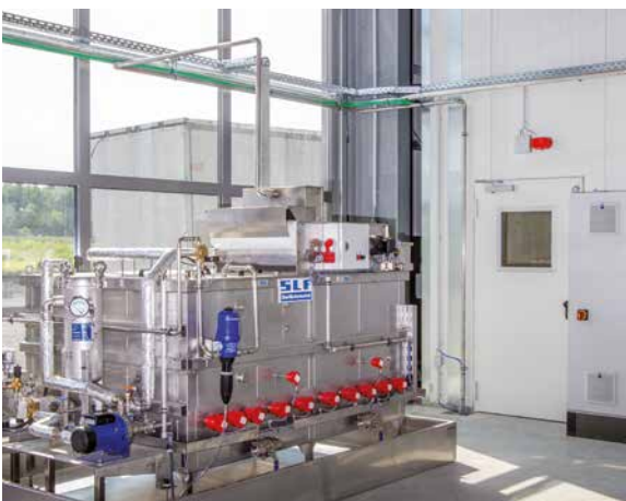
Prozesswasseraufbereitungsanlage einer Waschkabine
