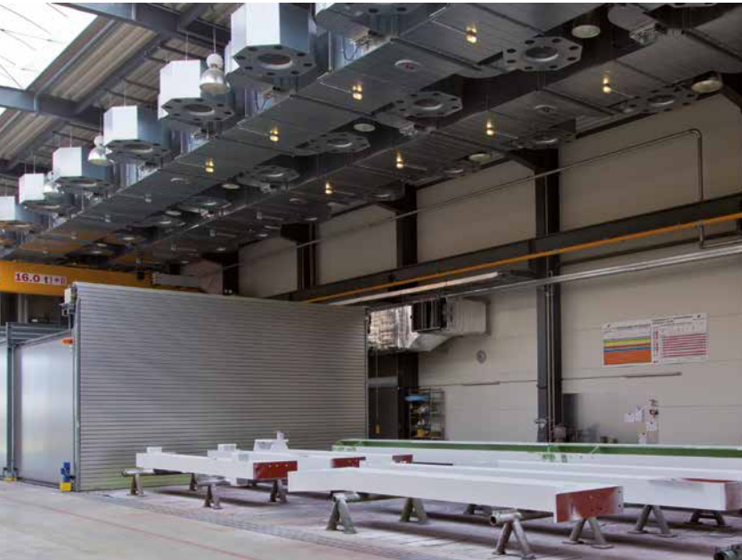
Freiflächenlackieranlage für Stahlbaukomponenten und -konstruktionen
