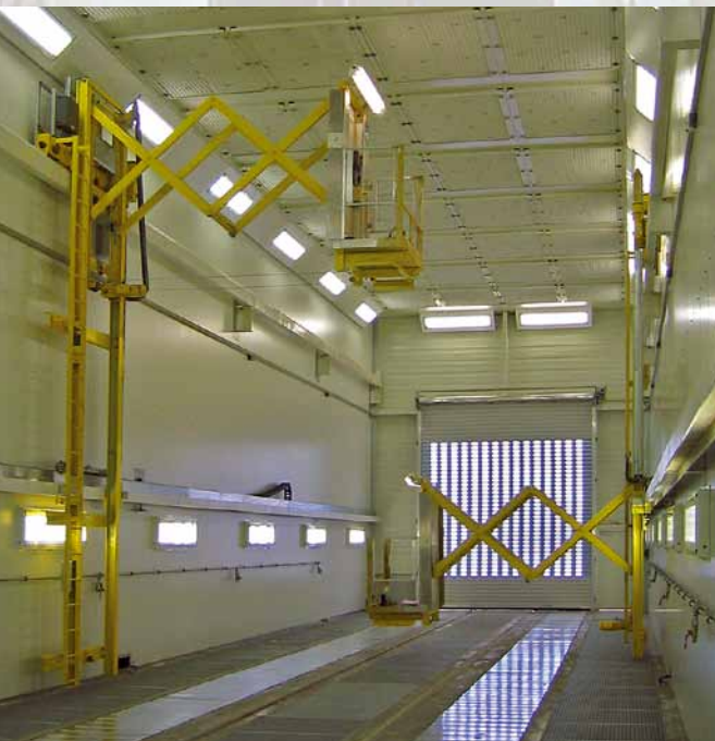
Boya kabininde, yan duvara bağlı, hareketli Makaslı-Teleskop-Platform.
