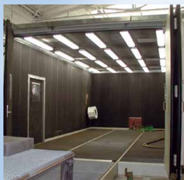
Дробеструйное помещение с пневматической рециркуляцией дроби без фундамента
