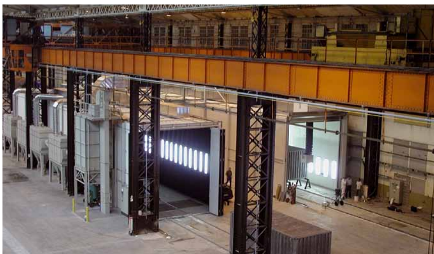
Дробеструйная камера в маломощном исполнении для обработки башенных кранов.
