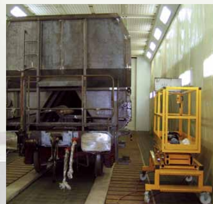
Комбинированная окрасочно-сушильная камера с секционной приточно-вытяжной вентиляцией.
