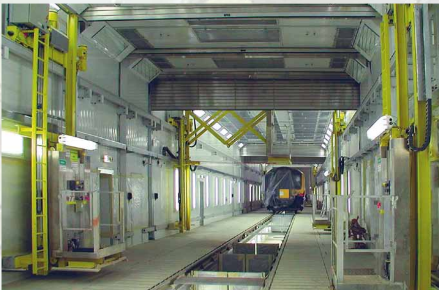
Pomosty przyściennie w kabinie lakierniczej do malowania wagonów w firmie Siemens SA Transportation Systems, Krefeld.
