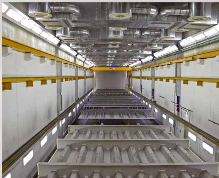
Kombinowana kabina natryskowa i suszarnicza do elementów mostowych z sekcijną wentylacją za pomocą dysz dalekiego zasięgu.
