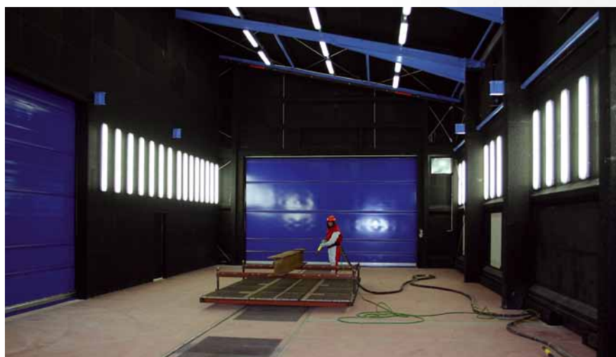
Komora do strumieniowania elementów do statków stoczni Meyer wraz z częściowo powierzchniowym pneumatycznym odciąganiem powrotnym.
