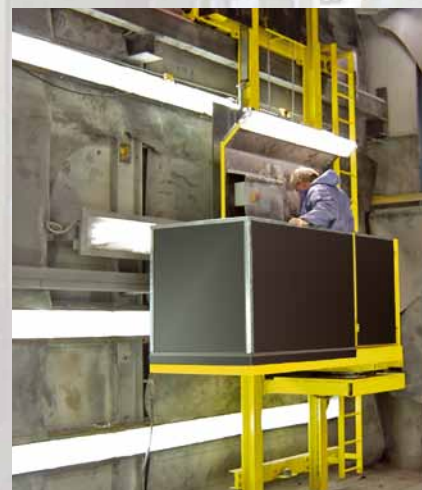
Przesuwane pomosty robocze obrotowe w komorze do swobodnego strumieniowania.
