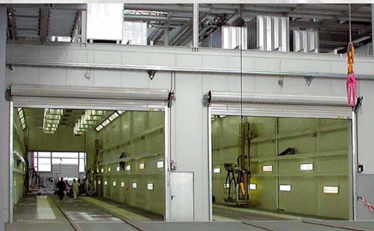
Cabine combinada de pintura e secagem com ventilação transversal, por meio de turbina e bocas de longo alcance.
