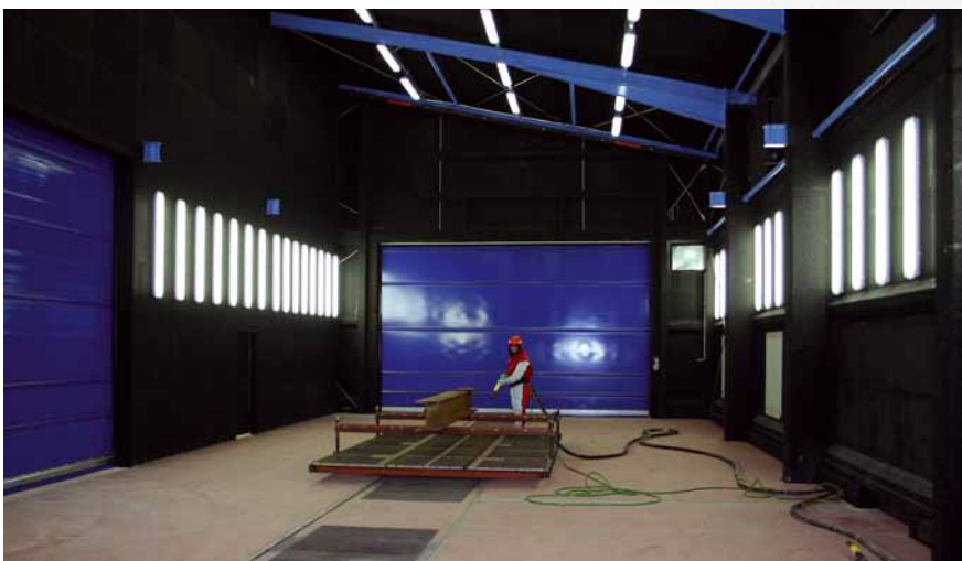
Cabine de decapagem para componentes de navios no Estaleiro Meyer incl. recuperação parcial de granalha de modo pneumático.
