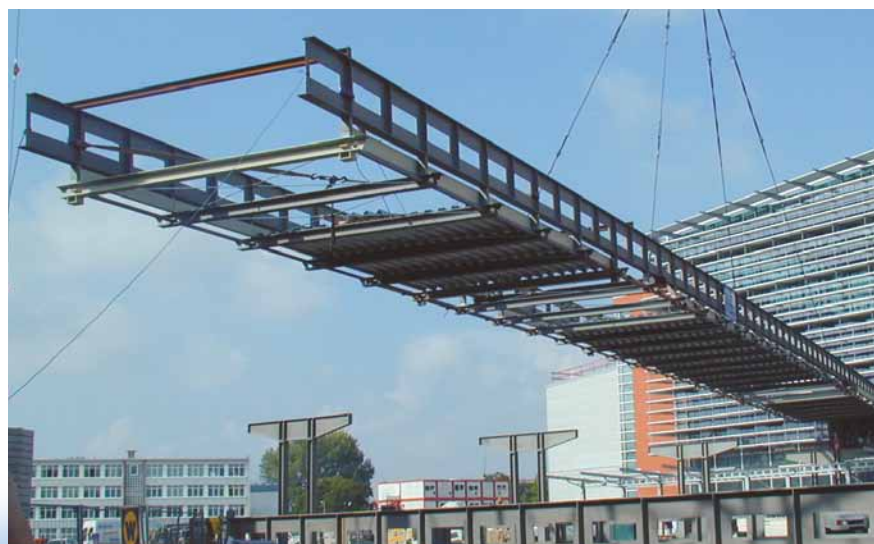
Ponte de passageiros para o Aeroporto de Dresden, com tratamento anti-corrosão SLF em Mühlau.
