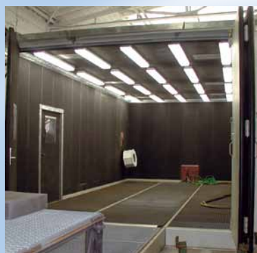
Cabine de decapagem com sistema de recuperação pneumático de granalha.
