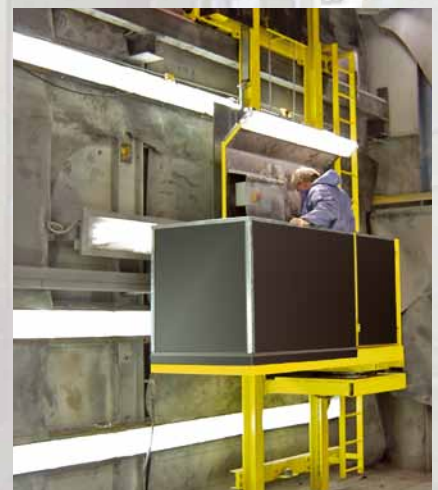
Plataforma giratório móvel em cabine de decapagem.
