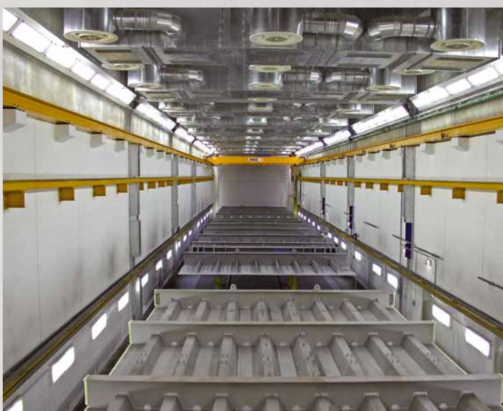
Cabine de peinture et de séchage pour des éléments de pont avec ventilation par zones par des buses d'injection à longue portée.
