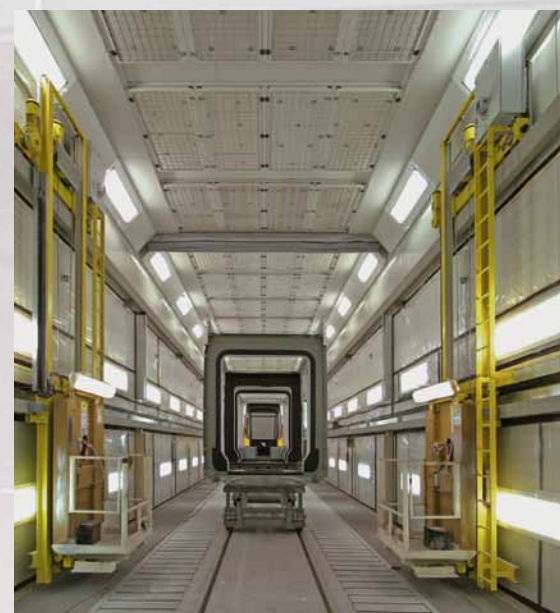
Cabine de peinture et de séchage pour des voitures de voyageurs avec ventilation par zones.
