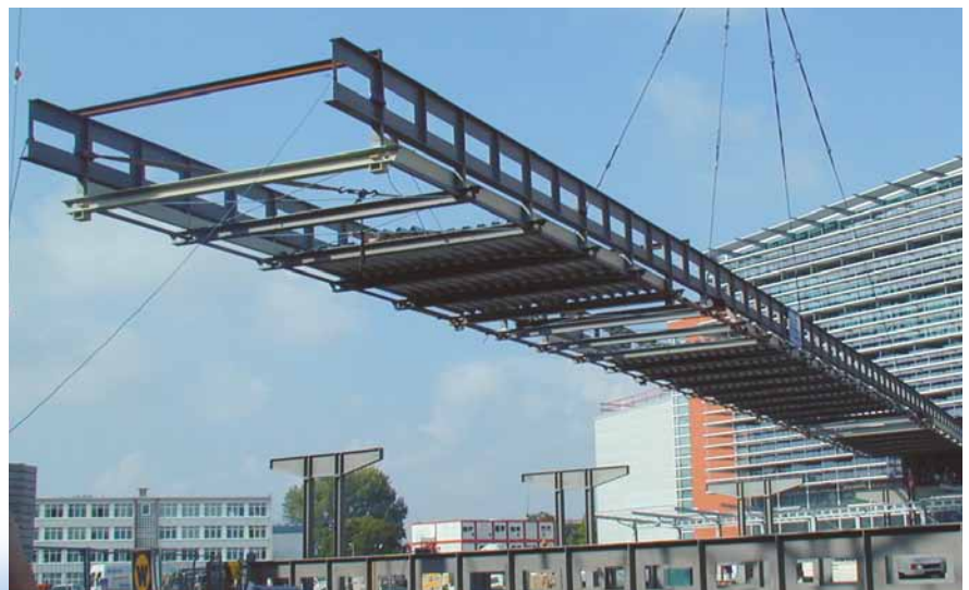
Pasarela de pasajeros del Aeropuerto de Desden, con tratamiento en el centro para Anti-Corrosión SLF en Mühlau.
