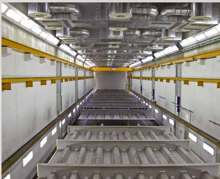
Cabina combinada de pintura y secado con ventilación seccional mediante boquillas de largo alcance para elementos de puentes.
