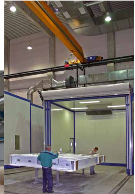
Freiflächenlackieranlage mit Teleskoprockner.
